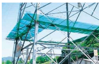
昇塔防止装置
