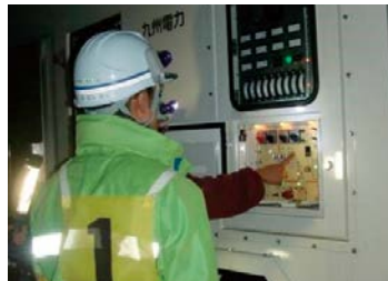
◇高圧発電機車による電源供給(夜間)
