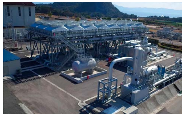
山川バイナリー発電所
