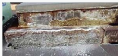
コンクリート構造物の酸性劣化状況【補修前】
