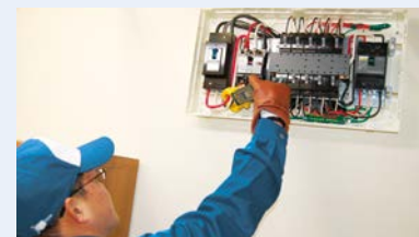
分電盤の点検
