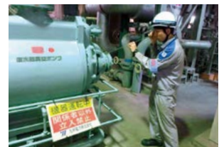
設備異常の早期発見パトロール(聴診棒による異音の確認)
