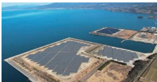
大村メガソーラー発電所
