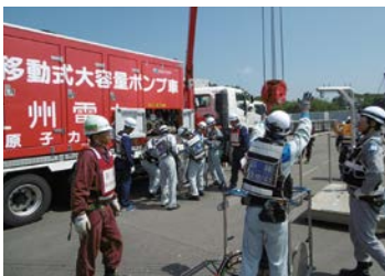
◇移動式大容量ポンプ車の設置
