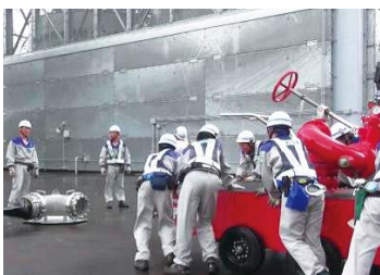
◇放水砲の設置
