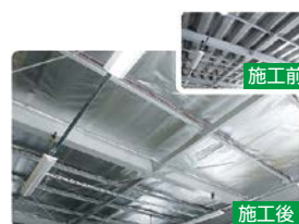
夏場ピーク時の屋根からの熱量を約9割カット 「遮熱シート(トップヒートバリアー)」(九電テクノシステムズ株)
