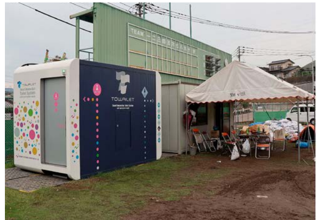
「令和元年九州北部豪雨」の際に被災地に設置した「トワイレ」
