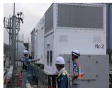
大容量空冷式発電機の起動
