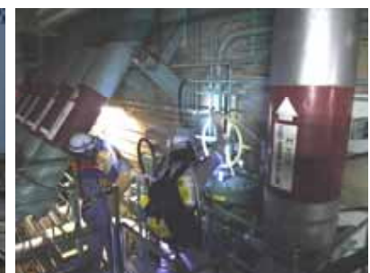
主蒸気逃し弁操作
