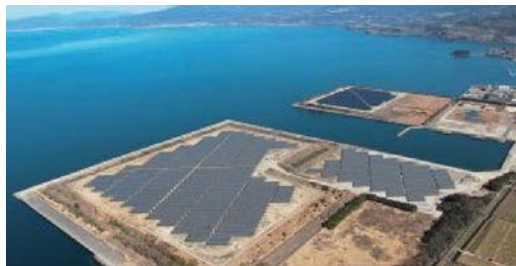
大村メガソーラー発電所
