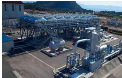
山川バイナリー発電所
