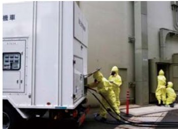
◇高圧発電機車の電源ケーブル接続
