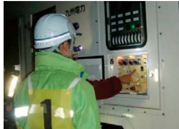
◇高圧発電機車による電源供給(夜間)
