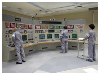
◇シミュレータを使用した運転操作
