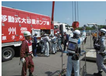
◇移動式大容量ポンプ車の設置
