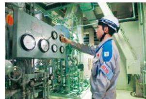
指差呼称による計器の確認
