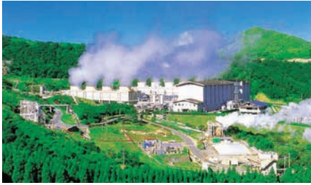
八丁原地熱発電所(大分県)
