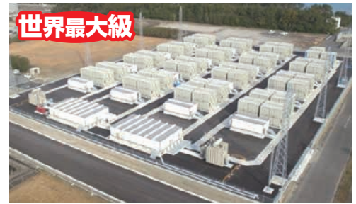
豊前蓄電池変電所(福岡県)
