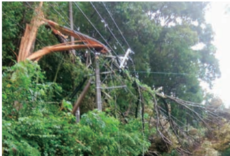
倒木による支持物折損
