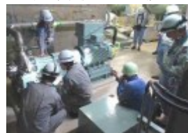
常設電動 注入ポンプ点検
