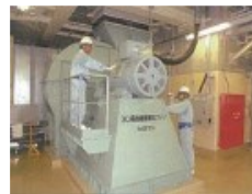
運転中機器の点検
