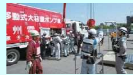
移動式大容量ポンプ車の設置
