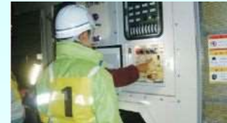
高圧発電機車による電源供給(夜間)
