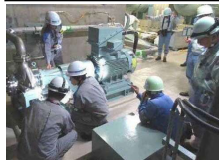
常設電動注入ポンプ点検
