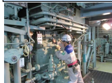
非常用ディーゼル発電機の作動試験
