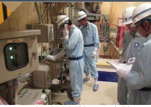
緊急用通信機器の点検
