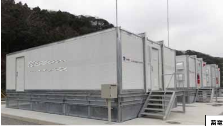
受電設備、蓄電池収納建屋写真
