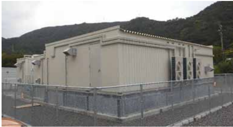
蓄電池収納建屋写真
