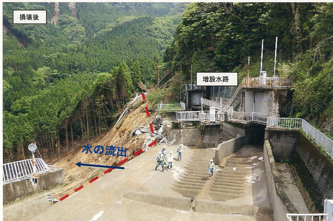
写真2.5 ヘッドタンク全景 損壊後 (撮影:H28.5.15)
