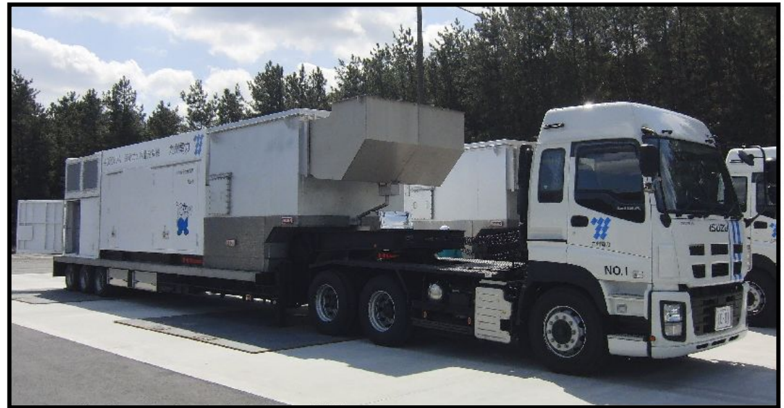
移動式大容量発電機
