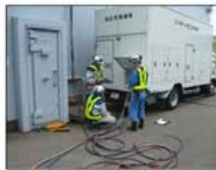
◇高圧発電機車による電源供給
