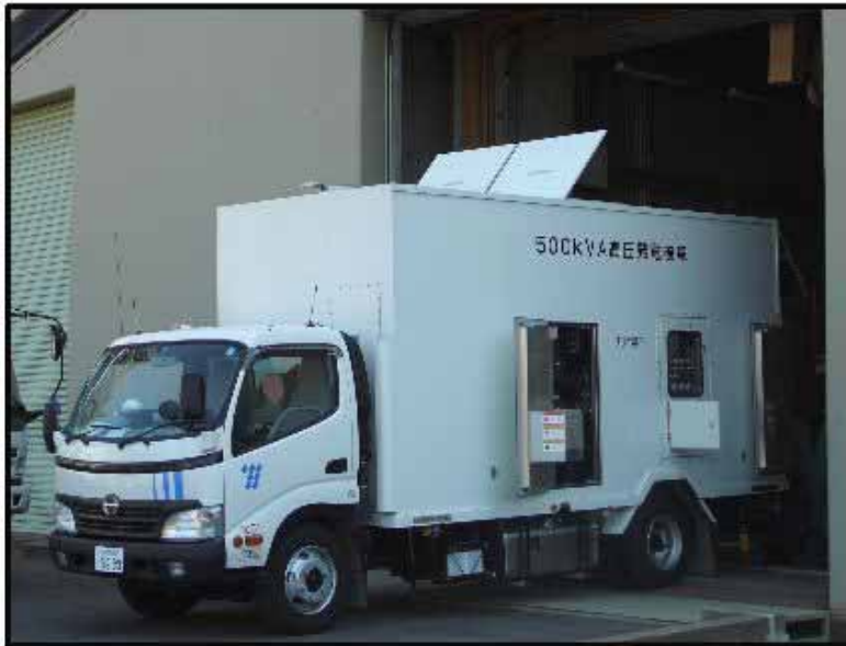
高圧発電機車
