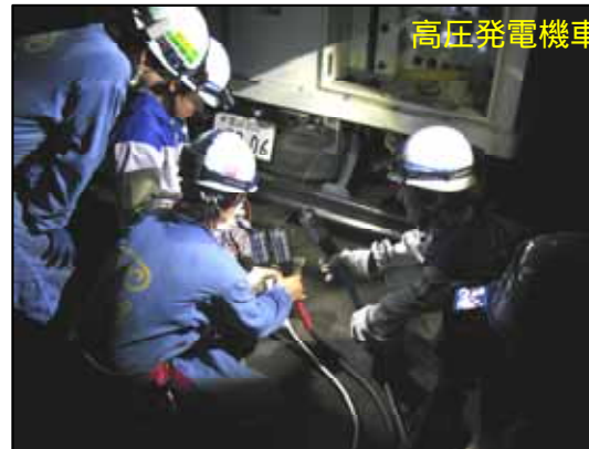
高圧発電機車の設置
