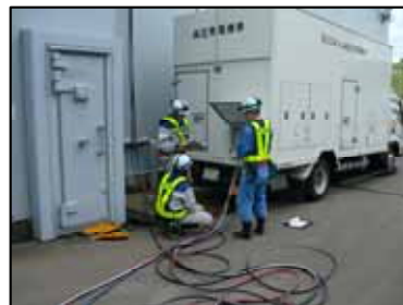
高圧発電機車による電源供給
