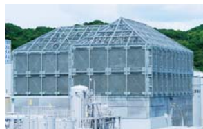
屋外タンクの竜巻防護ネット
