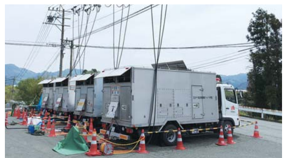
高圧発電機車(中部電力株)による送電
