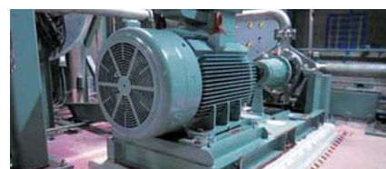
常設電動注入ポンプ
