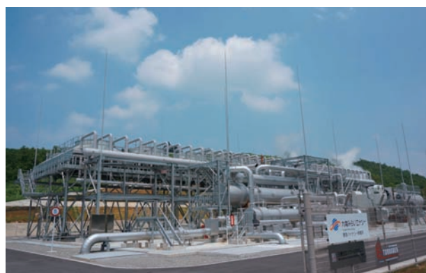
菅原バイナリー発電所
