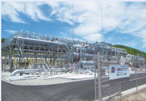
発電設備の外観
