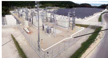
【太陽光パネル】
