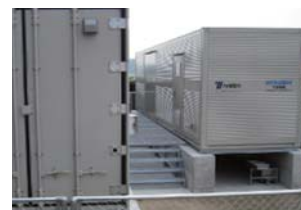
受電設備・蓄電池等収納コンテナ
