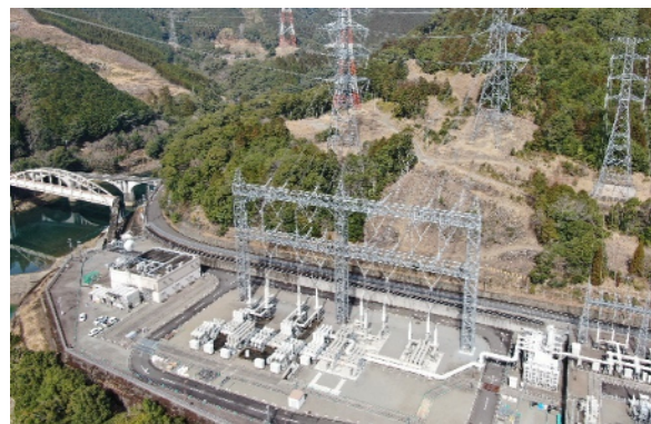
〔宮崎県木城町 ひむか変電所〕
