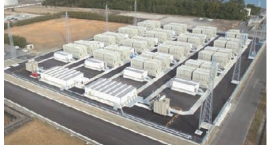
国内最大級の大容量蓄電システムを備えた豊前蓄電池変電所(福岡県)
