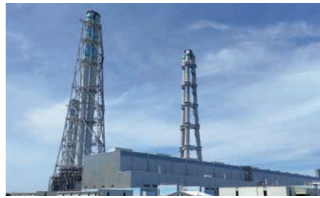
高効率のコンバインドサイクル発電方式を採用した新大分発電所(大分県)
