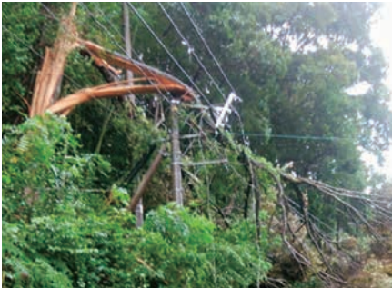
倒木による支持物折損
