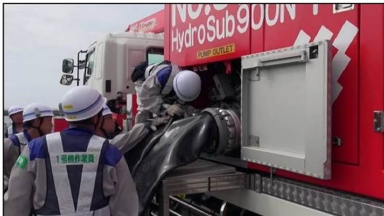
移動式大容量ポンプ車の設置
