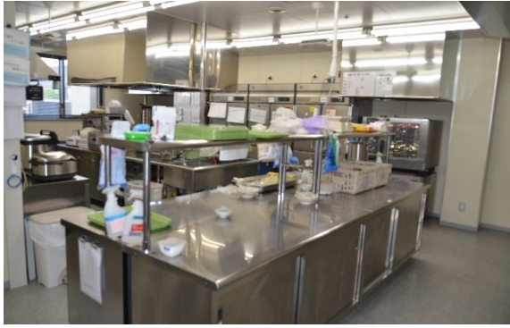
フラットで掃除・作業がしやすい電化厨房
