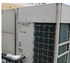
ヒートポンプ (空調・給湯)
