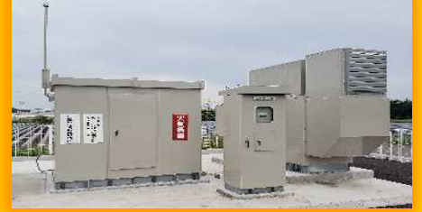
非常用発電機
