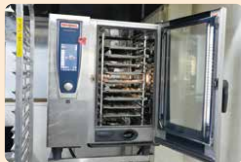
スチームコンベクションオーブン (10段 17.2kW×2台、6段 10.1kW×1台)
