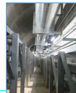
電源ケーブル等が通る通路
