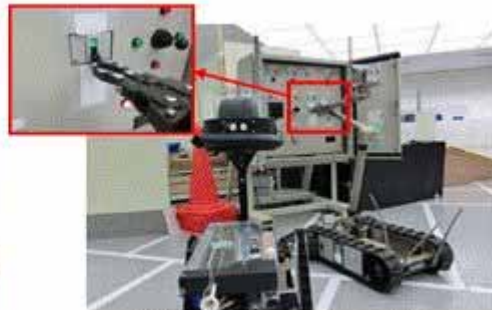
制御盤を開放しスイッチ操作
