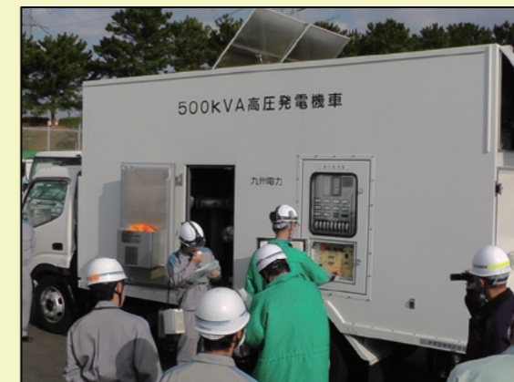
所外からの電源喪失時に、高圧発電機車を用いて電源を供給
