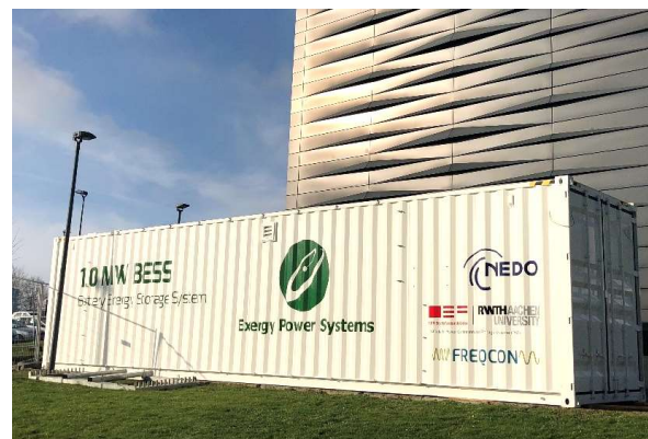
▲ エクセルギー・パワー・システムズの蓄電池システムの外観 (エクセルギー・パワー・システムズ提供)
