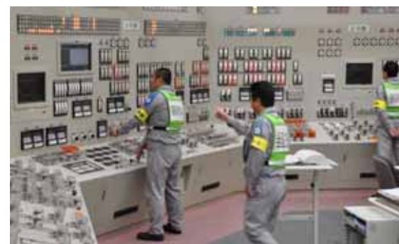
発電所の運転状態監視
