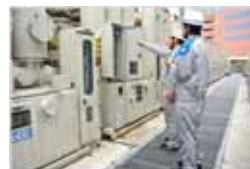
水力発電・変電設備の巡視
