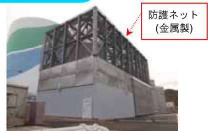
復水タンク竜巻防護対策
