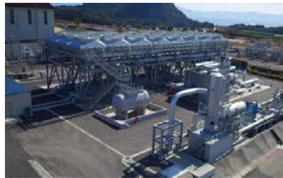
山川バイナリー発電所
