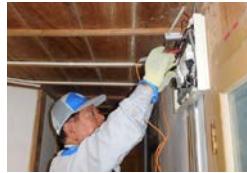
屋内配線診断(熊毛配電事業所)
