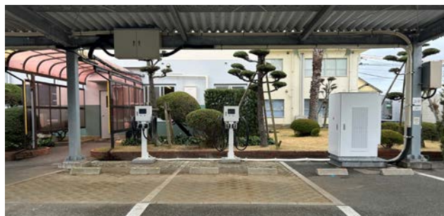
EV用充放電器(試作機)の設置状況
