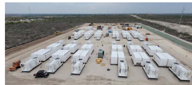
米国 蓄電池事業 出力 200MW、容量 400MWh(出力100MW、容量200MWh × 2地点)
