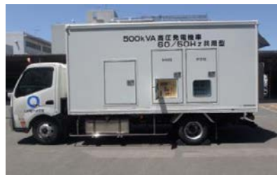
高圧発電機車
