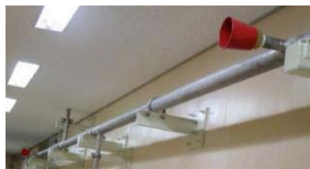
自動消火設備(ハロン消火設備)
