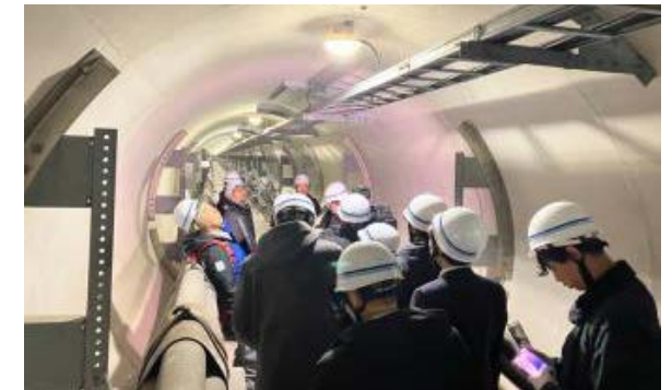
赤坂変電所・地中送電線設備見学会（報道機関向け）
