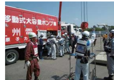
移動式大容量ポンプ車の設置
