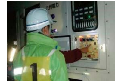
高圧発電機車による電源供給(夜間)
