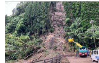
土砂崩れによる設備被害箇所の復旧状況
