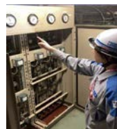
指差呼称による計器の確認
