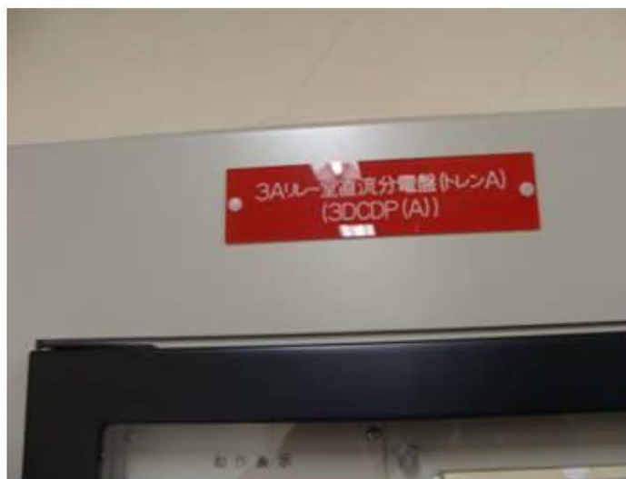
リレー室直流分電盤 (トレンA)
