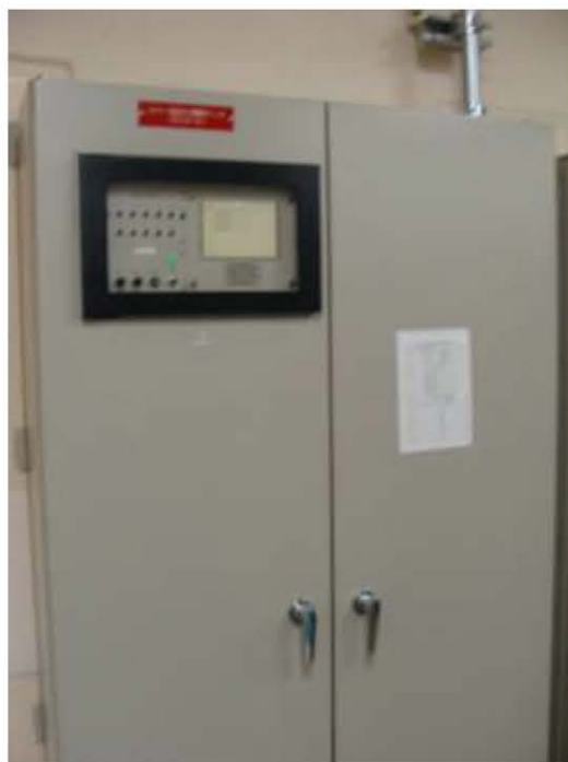
リレー室直流分電盤 (トレンA)
