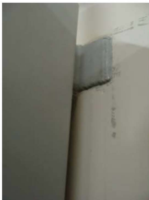
リレー室直流分電盤（トレンA）
