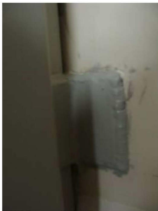
リレー室直流分電盤（トレンA）
