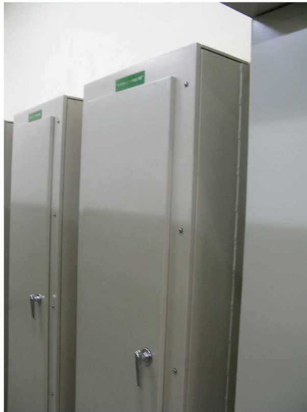
原子炉ソレノイド用直流分電盤（外観）
