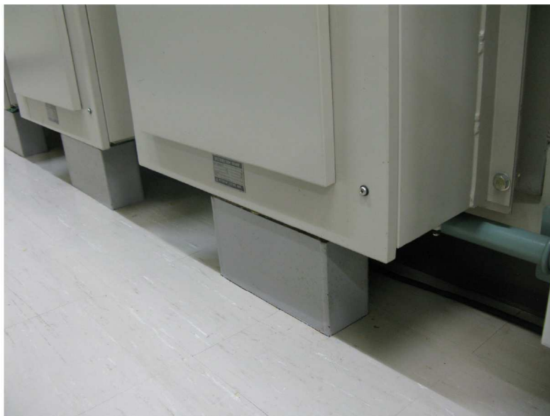
原子炉ソレノイド用直流分電盤（基礎ボルト）
