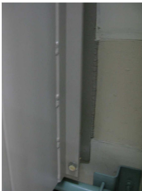
原子炉ソレノイド用直流分電盤（基礎ボルト）
