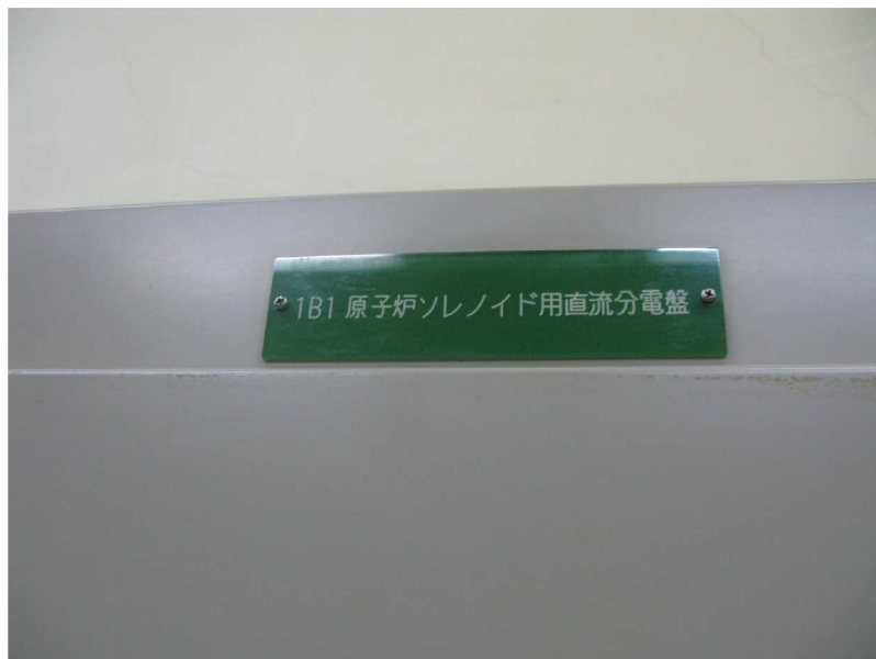
原子炉ソレノイド用直流分電盤（銘板）
