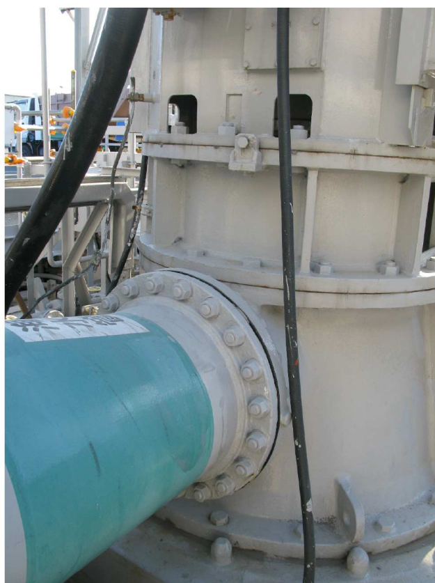
第1. 2. 2. a-4図 現場機器（海水ポンプ）
