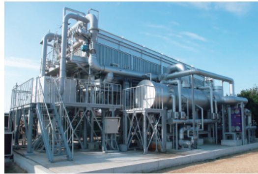
山川バイナリー発電設備
