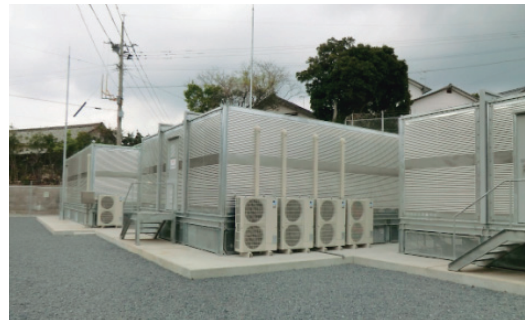
壱岐の実証試験設備(長崎県)
