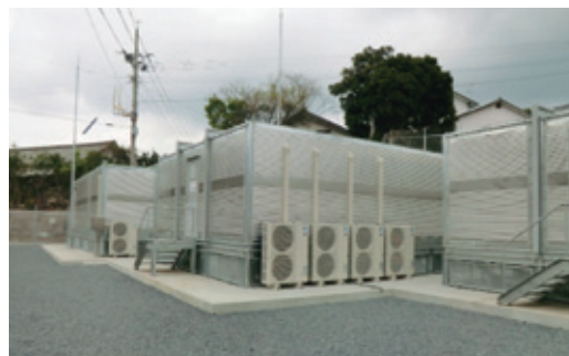
壱岐の実証試験設備(長崎県)
