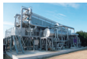
山川バイナリー発電設備
