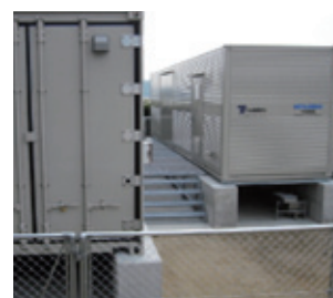
受電設備・蓄電池等収納コンテナ
