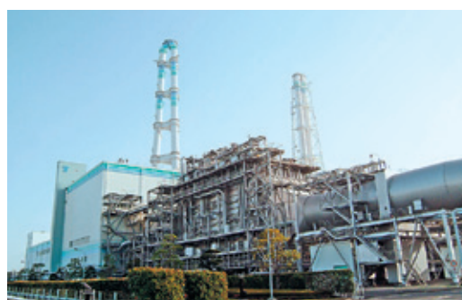
新大分発電所 (LNG 火力)
