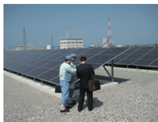
メガソーラー大牟田発電所
