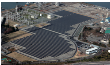
メガソーラー大牟田発電所
