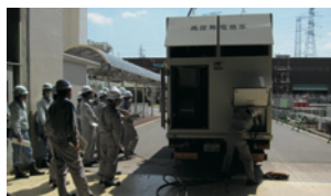
高圧発電機車の繋ぎ込み
