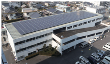
佐賀支社の太陽光発電設備(設備量:70kW)
