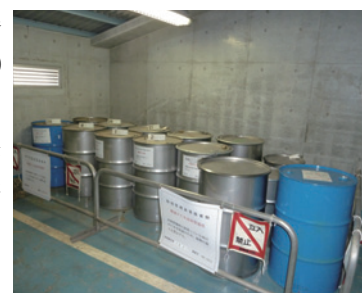
PCB廃棄物の保管・管理状況
