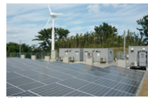
黒島の実証試験設備(鹿児島県)
