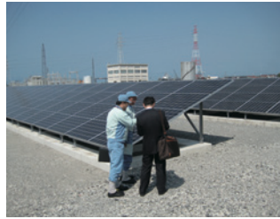
メガソーラー大牟田発電所
