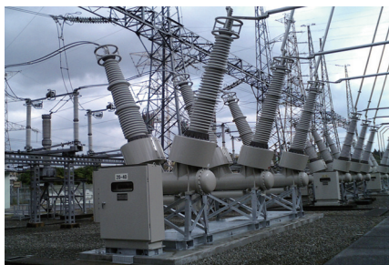
ガス絶縁開閉器
