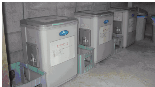
生ごみ処理機設置状況
