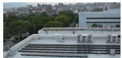
太陽光発電設備
