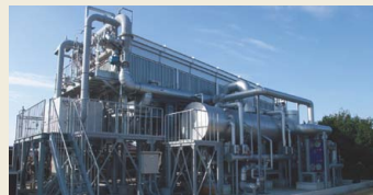
山川発電所のバイナリー発電設備
