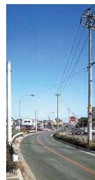
コンクリートポール
