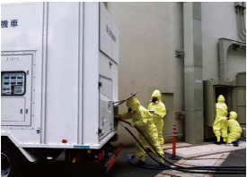
◇高圧発電機車の電源ケーブル接続
