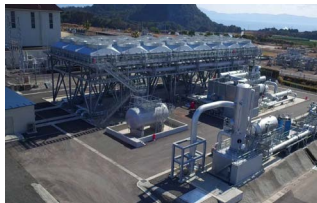
山川バイナリー発電所
