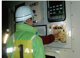
◇高圧発電機車による電源供給(夜間)
