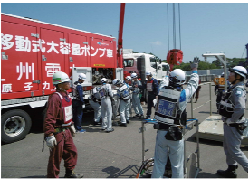
◇移動式大容量ポンプ車の設置
