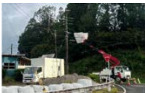
立入困難地域への高圧発電機車による送電
