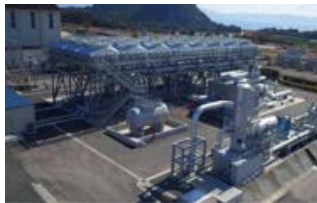
山川バイナリー発電所
