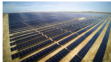
出資先のエンフィニティ・グローバル社が運営する太陽光発電所(米国・カリフォルニア州南部)
