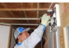
屋内配線診断（熊本配電事業所）
