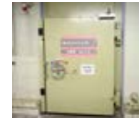
漏水対策(水密扉)
