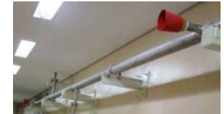
自動消火設備(ハロン消火設備)
