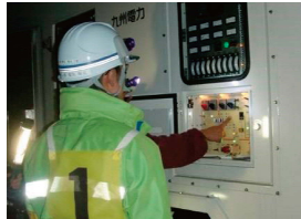
高圧発電機車による電源供給(夜間)
