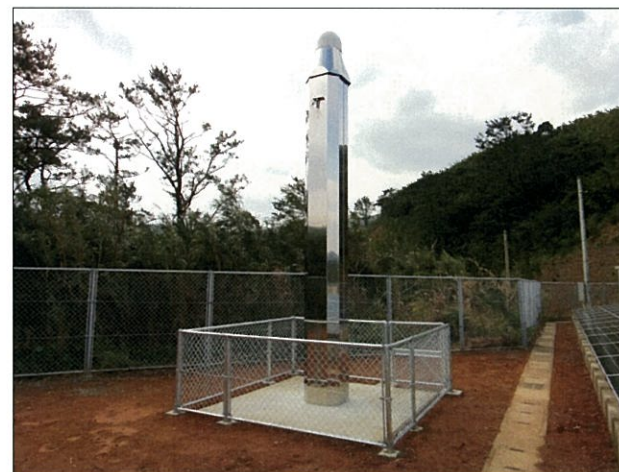
黒島の機器設置状況
