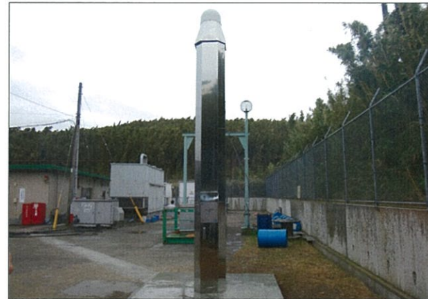
竹島の機器設置状況
