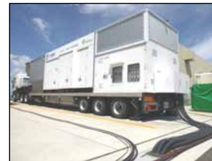
移動式大容量発電機
