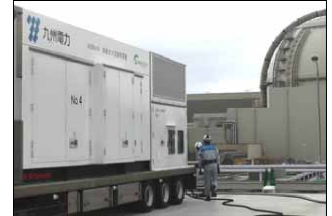
移動式大容量発電機による電源供給を実施
